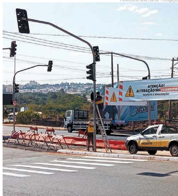
NOVA ODESSA | Conjunto semafórico em operação
