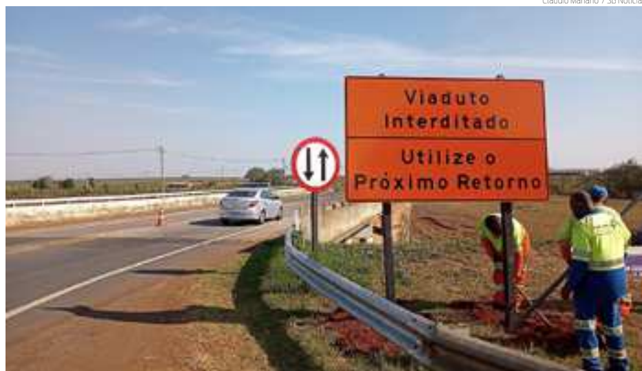
SP-304 | Viaduto já estava parcialmente bloqueado desde o final de semana passado
