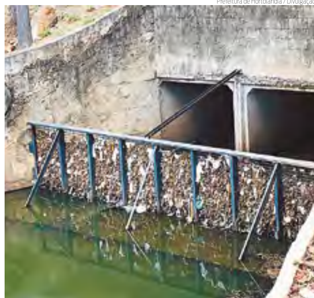
GRADE DE CONTENÇÃO | Evita lixo direto na lagoa
