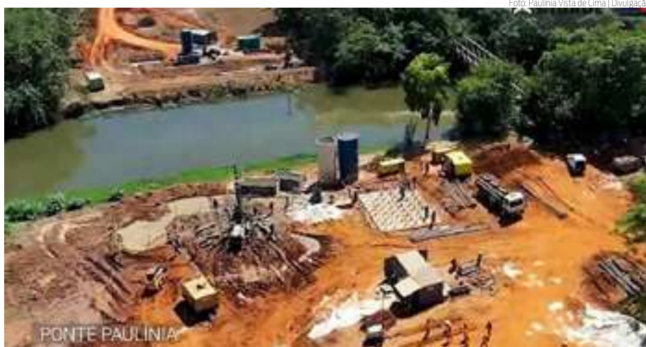
OBRAS | Explosão de compressor causou morte de operário nesta terça em Paulínia
