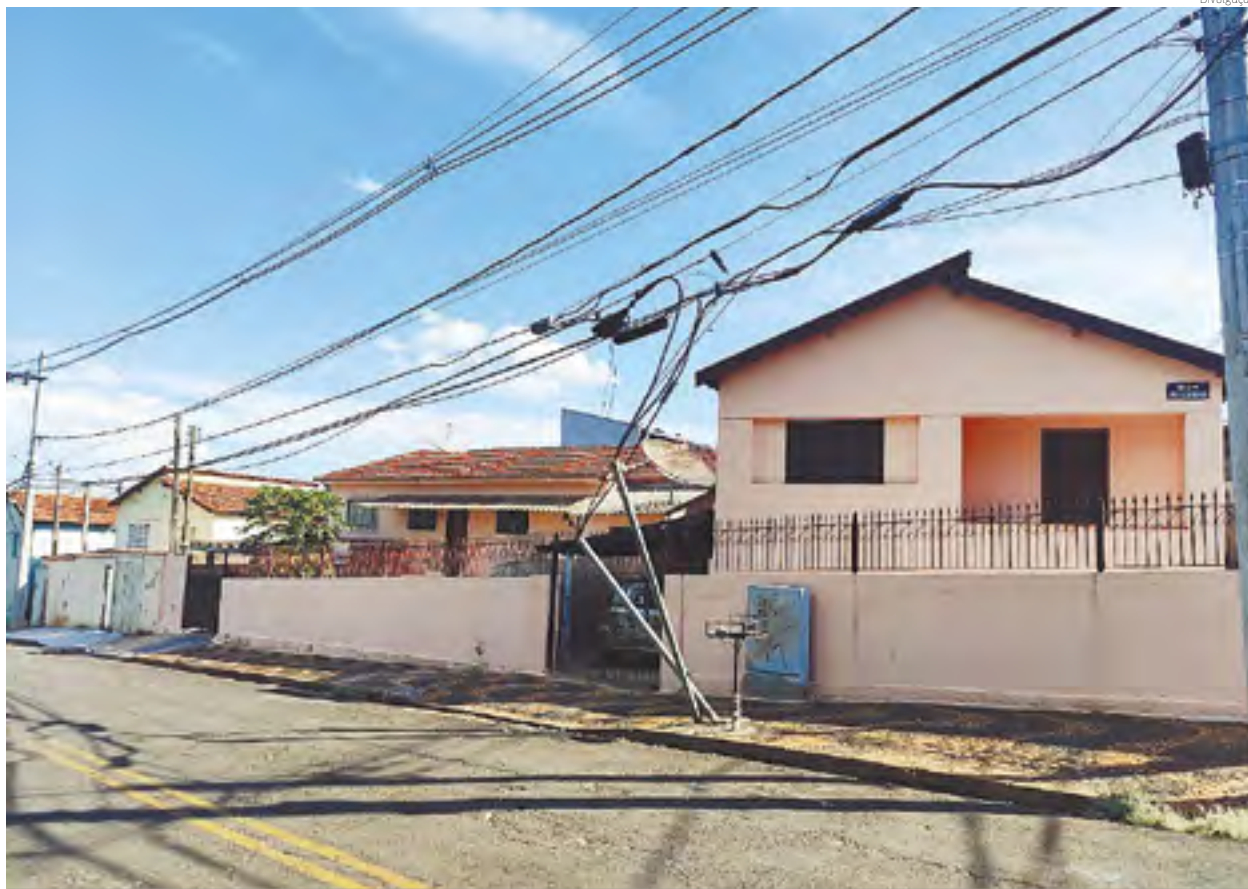
VILA LINÓPOLIS | Cabos pendurados pela Rua João Batista Rodrigues são a imagem da bagunça das empresas
