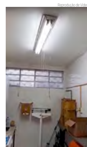
UBS | Vazamento no teto
