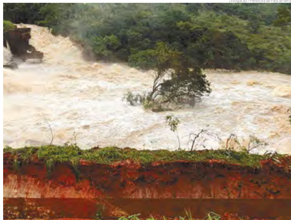
ÁGUA | A barragem da usina Carioca, em Pará de Minas, tem risco de rompimento
