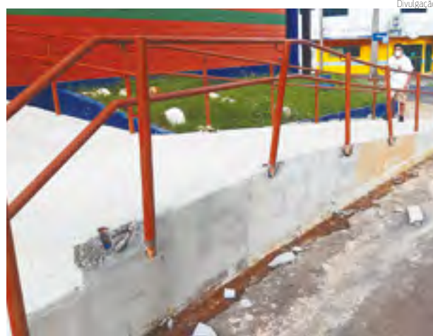
AMBULATÓRIO | Corrimão teve base danificada em N.O
