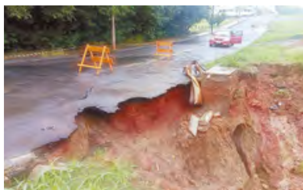
REPARO | Parte da pista cedeu e Sospa vai consertar
