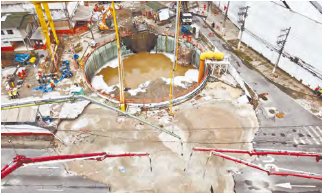
BURACONA VIA | Cratera aberta na última terça em obra da linha 6-laranja do Metrô na Marginal Tietê, em São Paulo
