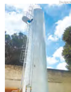
ZERO | Reservatório novo
