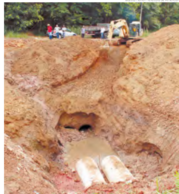
MEGA BURACO | Obra interditada trecho da Av. da Música
