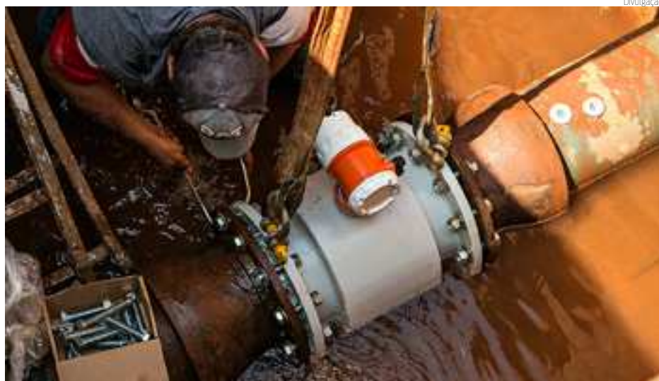
DAE | Macromedidores de vazão eletromagnéticos foram instalados na ETA IV
