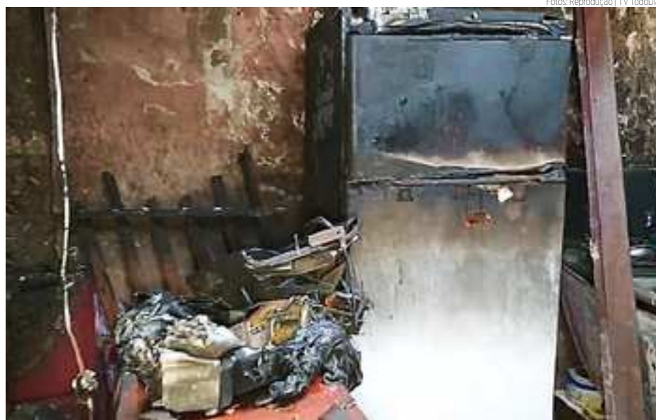
RESIDÊNCIA DESTRUÍDA | Maior parte da casa e dos móveis destruídos no incêndio
