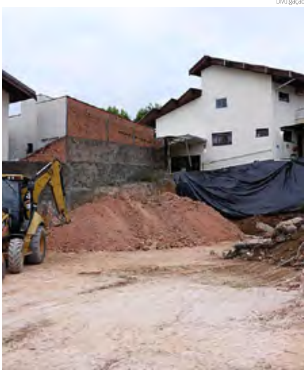
DESABAMENTO | Muro caiu de casa do Bela Vista
