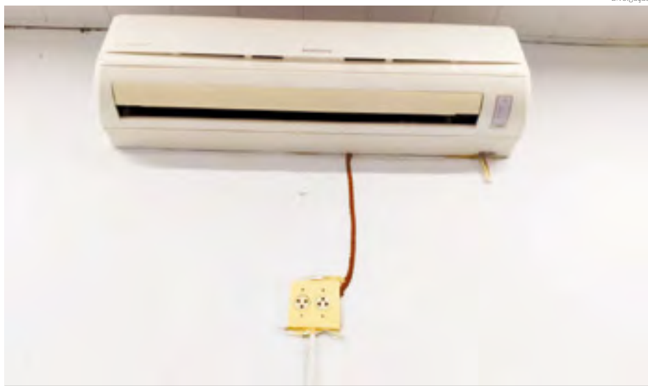
CUPIM | Escola Municipal Paulo Azenha tem cupim próximo ao ar-condicionado
