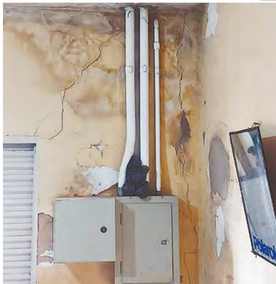
RISCO | Imóvel que abriga o Centro de Controle de Zoonoses tem diversas rachaduras
