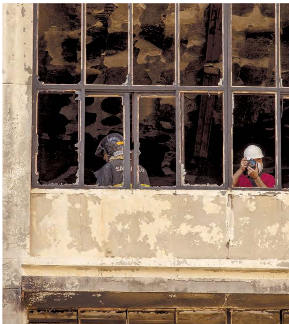
PERÍCIA | Bombeiros e peritos vistoriam prédio incendiado no centro de SP.
