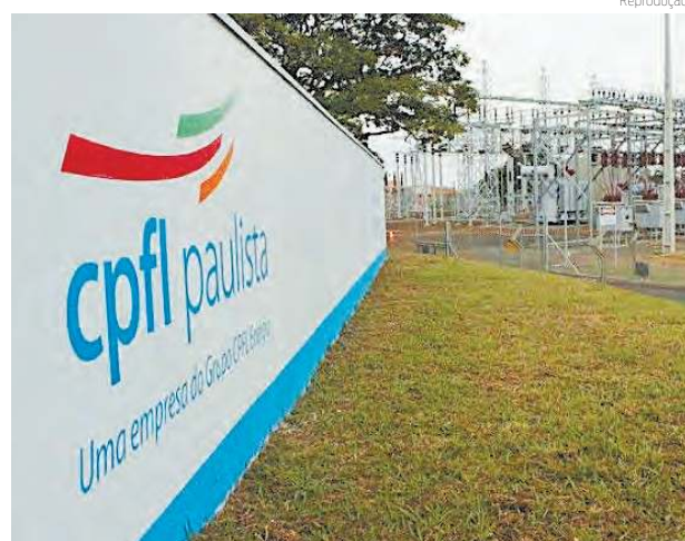
ASSALTO | Subestação da CPFL foi alvo de ladrões
