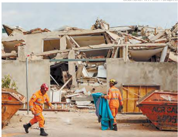
MINAS | Bombeiros atuam no desabamento ontem
