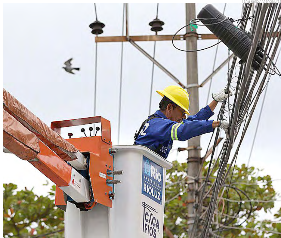
EMARANHADO | Funcionários da Riolut trabalham na retirada de fios em Benfica, zona norte da cidade.
